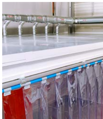
ROHRANSCHLÜSSE VON DER KABINE ZUR ABSAUGANLAGE
